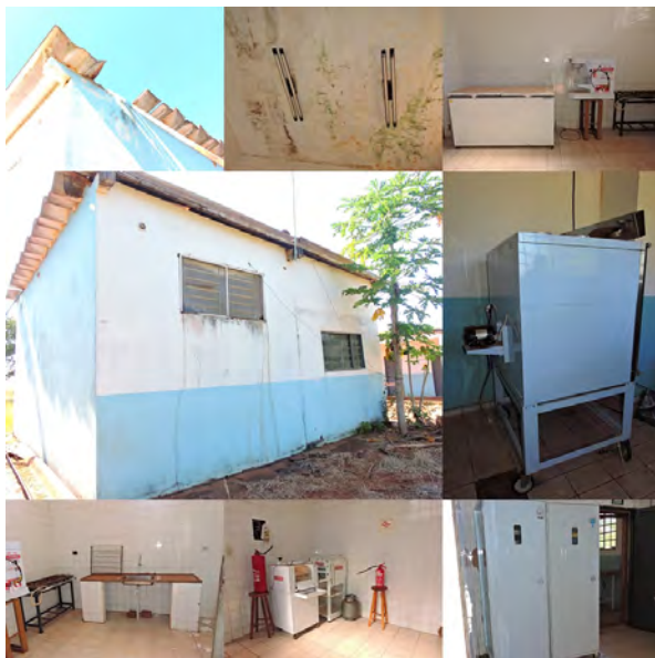
Painel Fotográfico 11: Problemas de infraestrutura na padaria da OMUS
